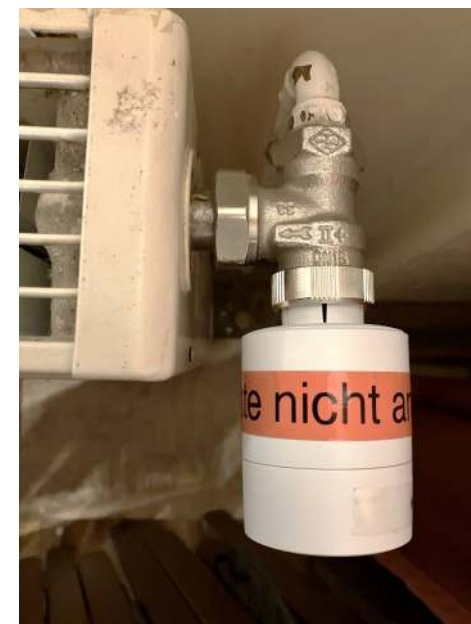
Die modernen Heizungsventile in den Gemeinderäumen werden vom Hausmeister per Smartphone gesteuert. Also bitte nicht selbst daran drehen!
